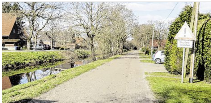
Ein Teilstück der Straße „An der Hinterwieke“ in Elisabethefehn zwischen dem Spechtweg und der Ramsloher Straße wird ausgebaut.
